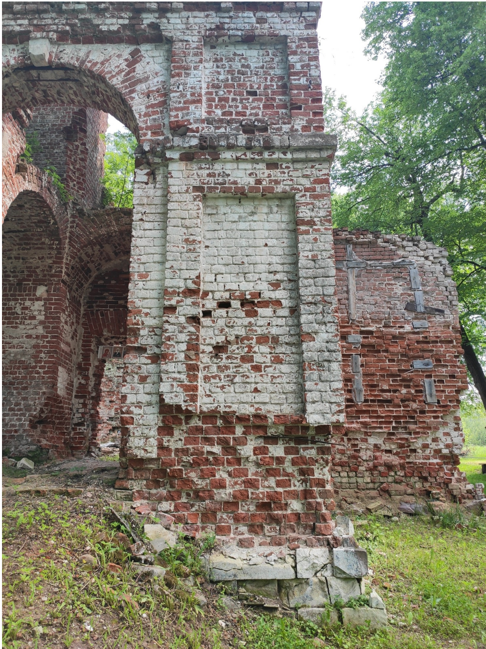
6. Повреждения кладки колокольни
