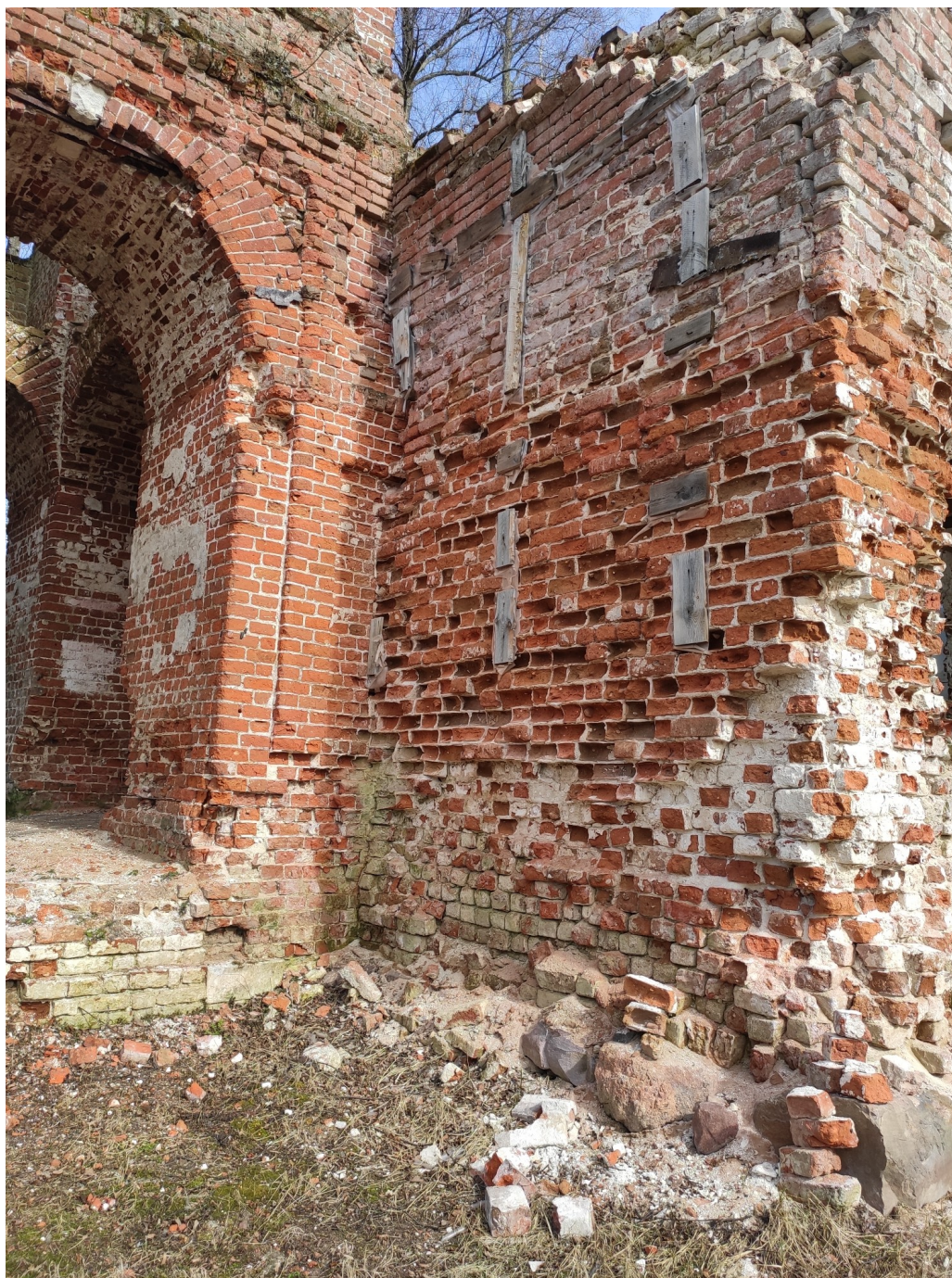
7. Поврежденная кладка западной стены трапезной
